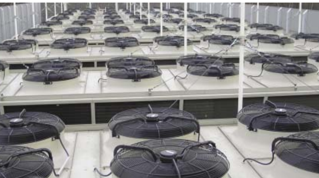
Die Kältemaschinen versorgen als Kältezentrale zwei bestehende Gebäude. The technology center is serving as a cooling center for the existing buildings.
